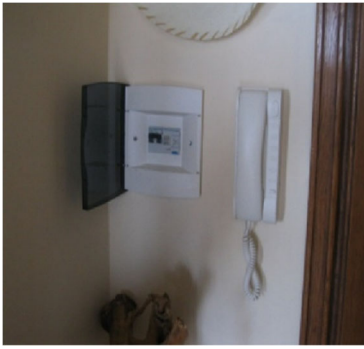
Sicherungskasten neben Eingangstüre (obere Wohnung) sowie Gegensprechanlage /Entriegelung Tor oben
