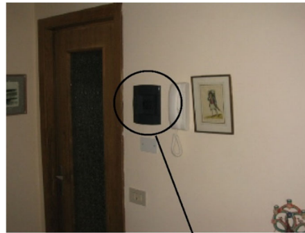
Sicherungskasten im Wohnzimmer (untere Wohnung) sowie Gegensprechanlage /Entriegelung Tor oben
